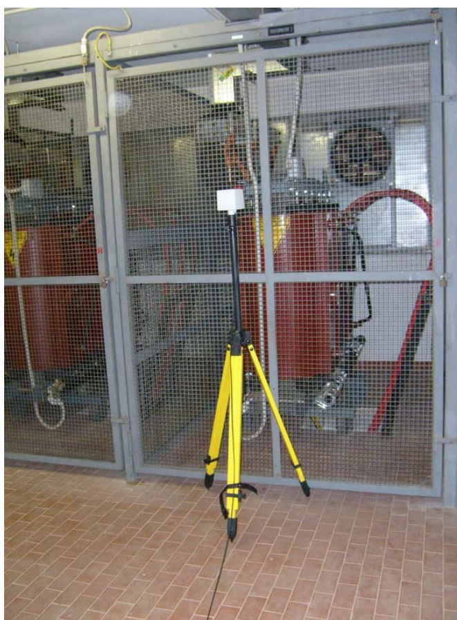
Figura 34: Misure presso trasformatore trifase 15kV/400V (P.O. Desenzano)
